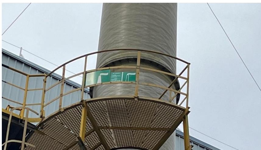
熔保炉组排气筒标识及采样监测平台
