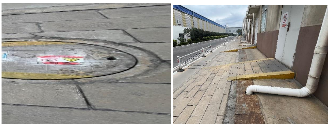
图 4.1-5 化粪池和雨水收集管
