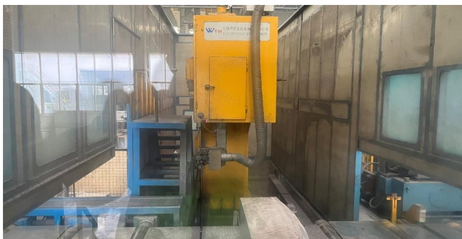
半封闭式锯切室及粉尘（锯屑）吸嘴
