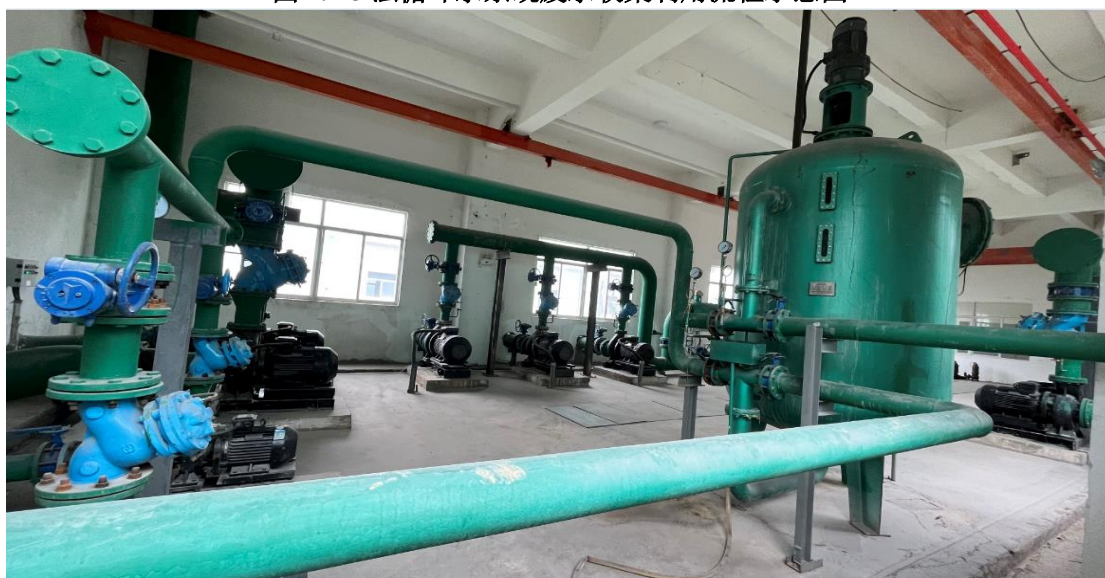
浊循环水系统泵房及桃壳过滤器
