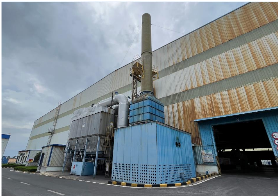
布袋除尘器+碱液喷淋塔+排气筒
