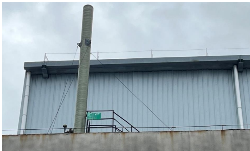
除碱车间排气筒标识及采样监测平台
