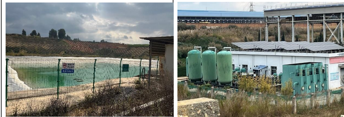
依托的初期雨水收集池
