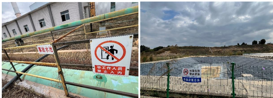
本项目自建事故废水收集池
