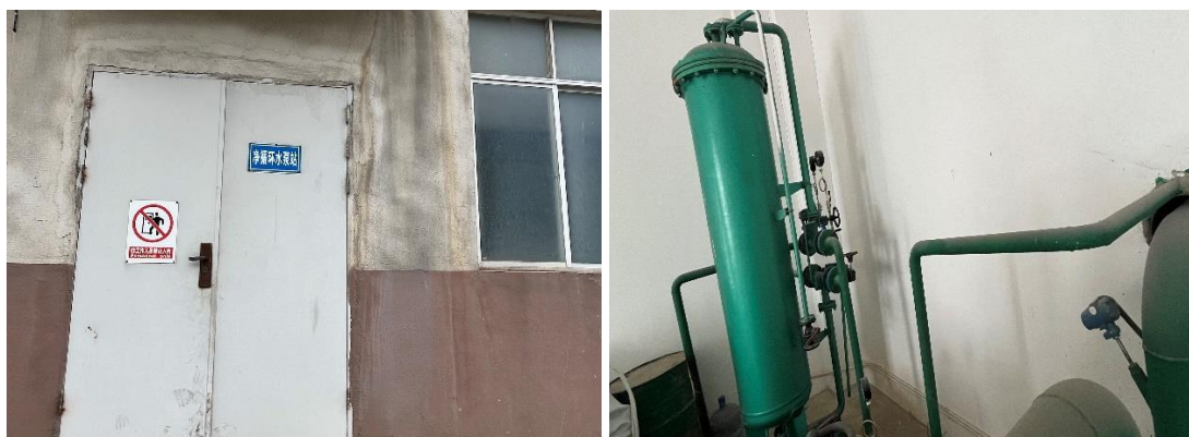
净循环水系统泵房
