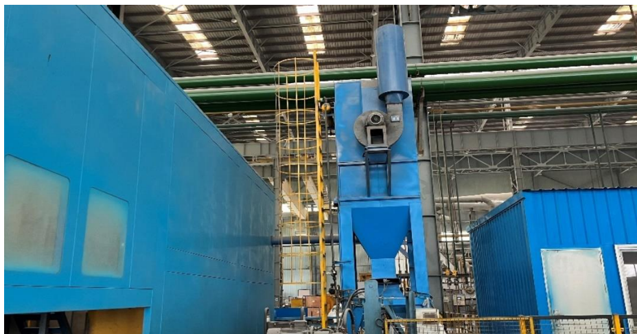
锯切工序配备的布袋除尘器
