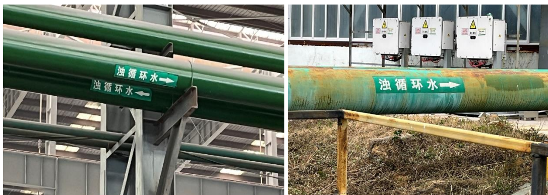
车间内油循环水系统管道
