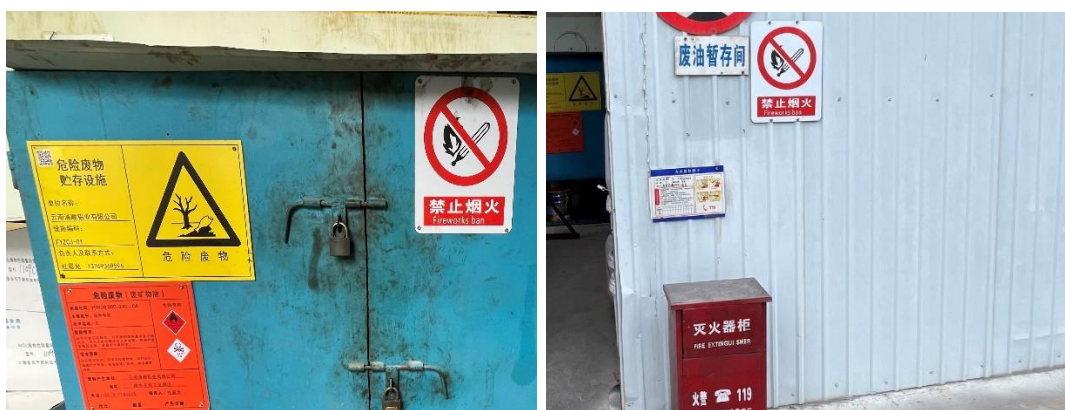
废油暂存柜相关规范标志牌
