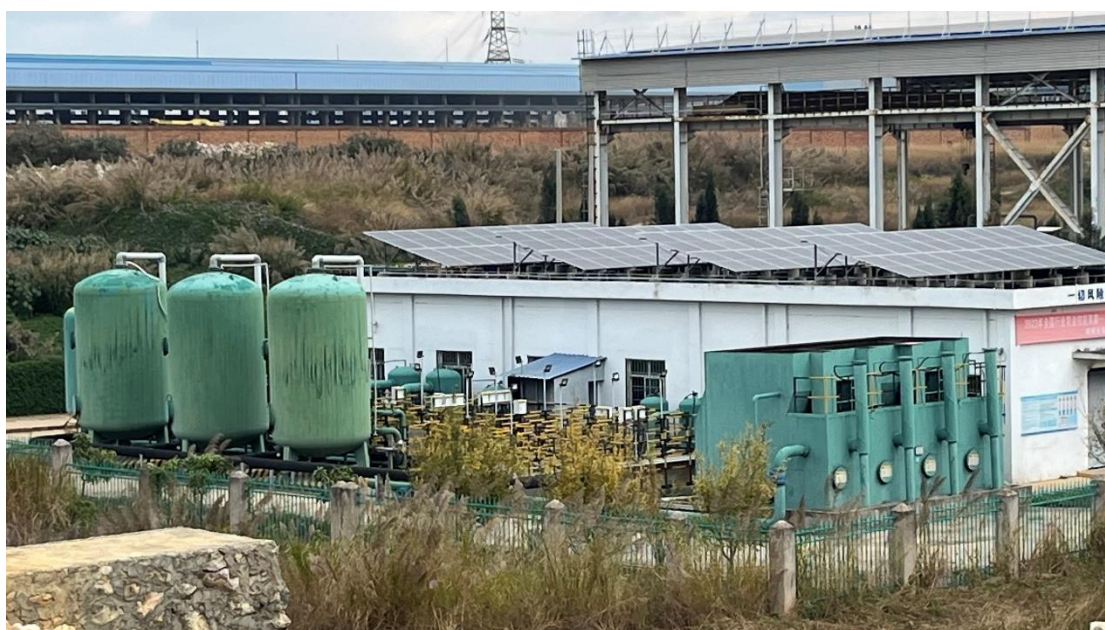
图 4.1-8 源鑫炭素污水处理站
